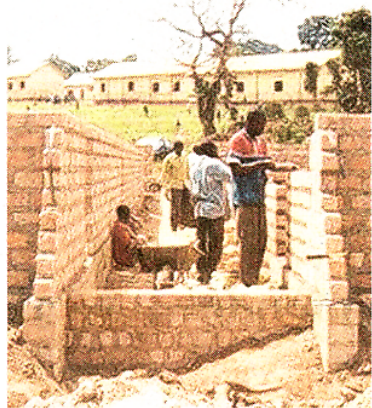
Hier wird noch gemauert, inzwischen stehen die Rohbauten für das Internat in Uganda schon. Im Hintergrund die mit Hilfe der deutschen Fans sanierten Schulgebäude.
